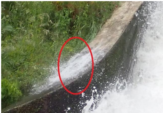
Spritzwasserüberschlag nach mittlerem Regen am 12. Juni 2019. Das Spritzwasser läuft fast komplett in die linke Böschung hinein
