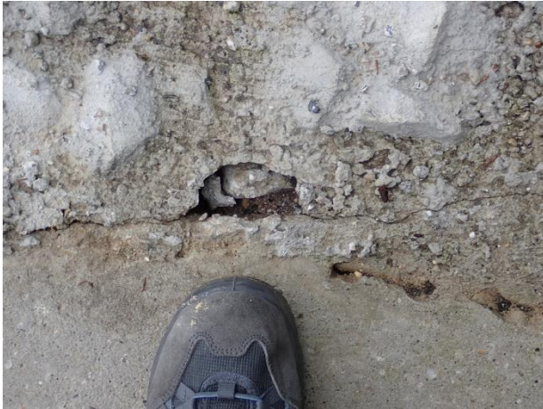
Hohlraum unter dem Spritzbeton. Es gibt noch weitere ähnliche Stellen. Datum: 6. Juni 2019
