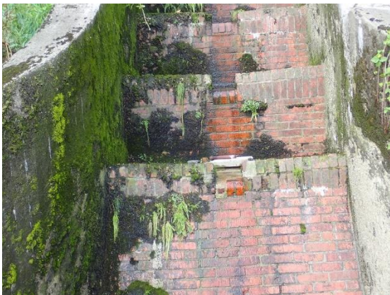
Feuchte Kaskadenrinne. Entfernung von Moos- und Pflanzenbewuchs ist dringend nötig.
